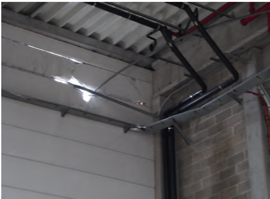
Photographie 19 : détérioration du mur autour du passage de la tuyauterie de chauffage.
