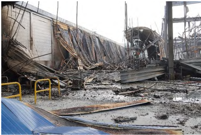
Photographie 4 : Vue du mur intercellules 1-2 avec une partie de la couverture encore accrochée.
