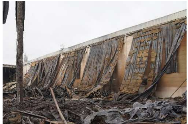
Photographie 5 : photo du mur intercellules 1-2 qui semble avoir bien résisté dans son ensemble.
