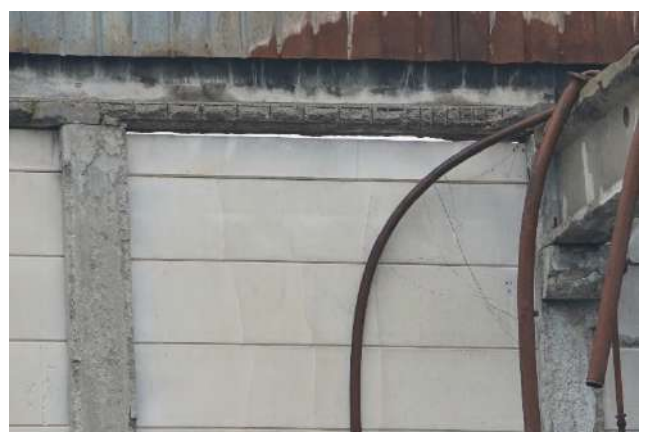
Photographie 9 : mur intercellule 1-2 qui fait apparaître un espace entre le mur et la poutre qui est particulièrement détériorée (ferrailles apparentes)
