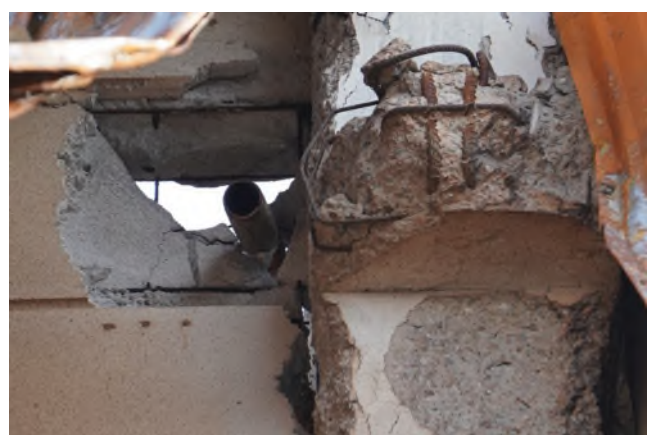
Photographie 13 : le mur intercellules 1-2 présente des dommages au niveau des passages de canalisations.
