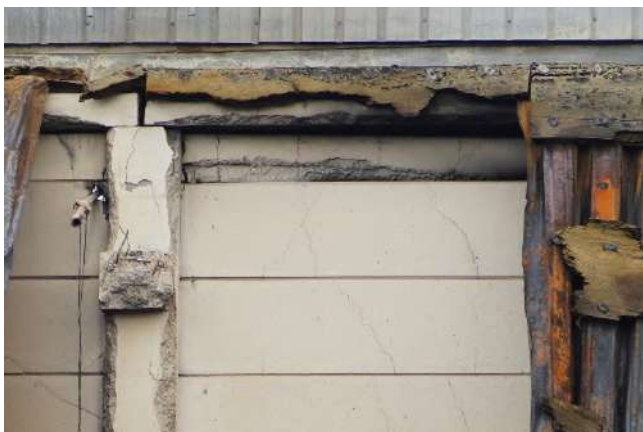
Photographie 6 : Gros plan sur la partie haute du mur intercellules particulièrement dégradé par les effets de l'incendie.
