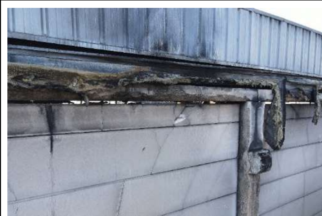
Photographie 17 : Vue de la partie supérieure du mur intercellules 2-3. Un espace est clairement visible entre la dernière plaque de béton et la poutre.
