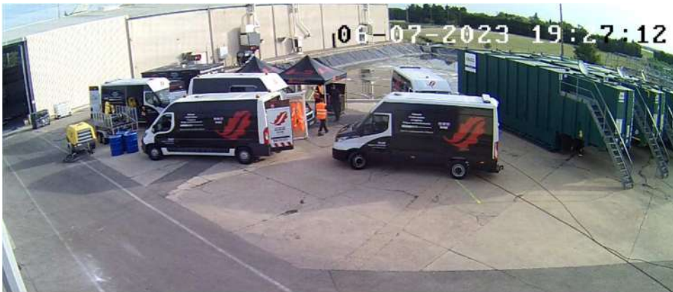
Photographie 41 : Installation de la base de vie de SECHE Urgences Interventions le jeudi 6 juillet (Source HYDRAPRO).
