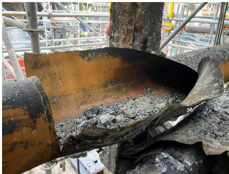
Figure n°5 : point de rupture au niveau de la ligne de naphta (crédit ExxonMobil)
