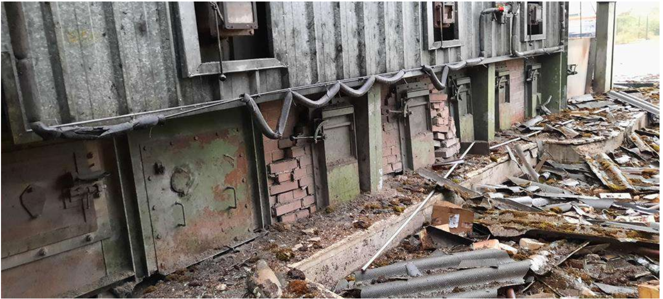
Photo n°4 : dommages constatés au niveau du soubassement du four
