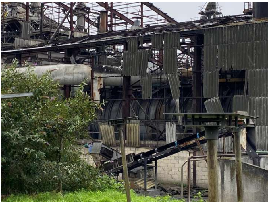
Photo n°1 : dégâts sur l'unité de déshydratation
