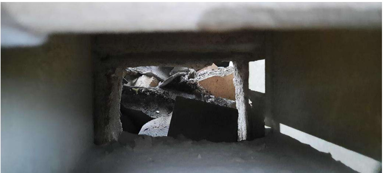
Photo n°5 : dommages constatés à l'intérieur du four
