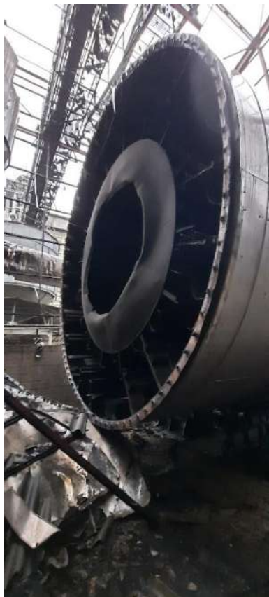
Photo n°10 : dommages constatés sur l'extrémité du sécheur à proximité des cyclones (crédit INQUEST)
