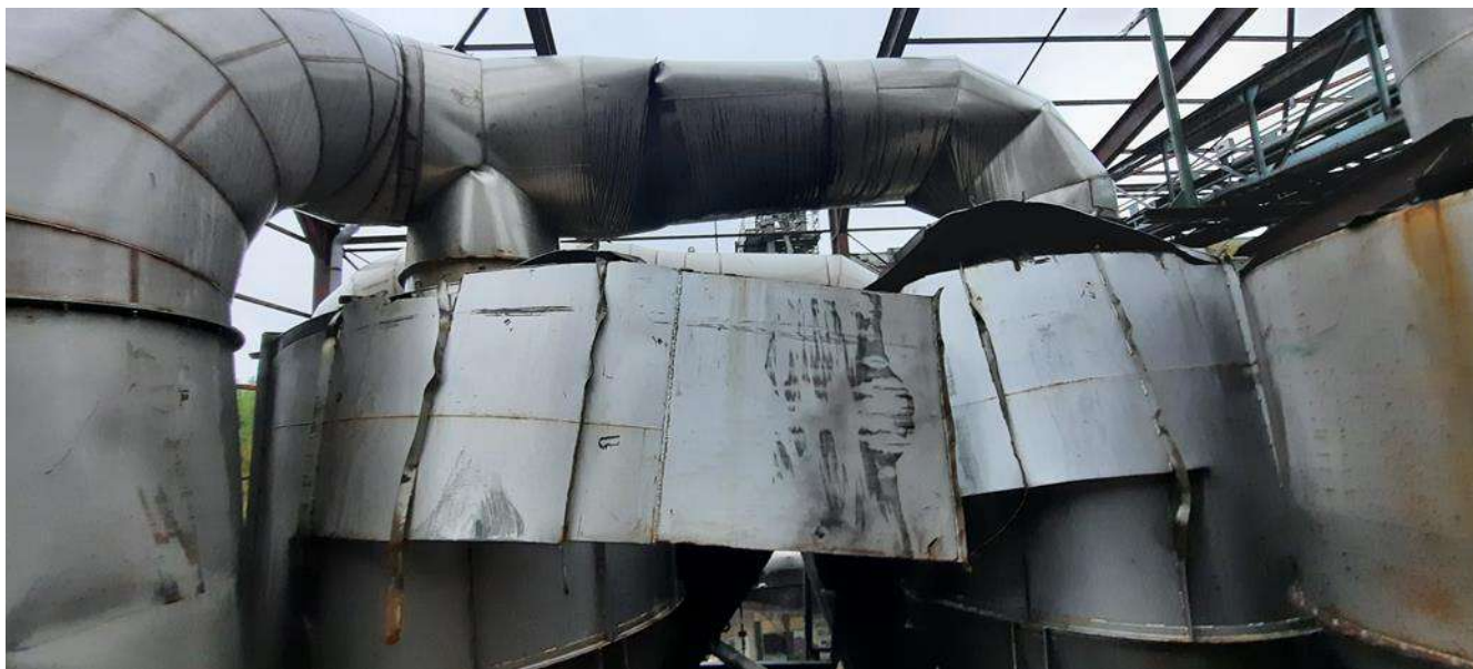
Photo n°7 : dommages constatés en partie haute des cyclones (crédit INQUEST)
