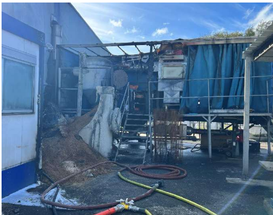
Figure n°1 : système de filtration des effluents gazeux après l'incendie (crédit SDIS 29)
