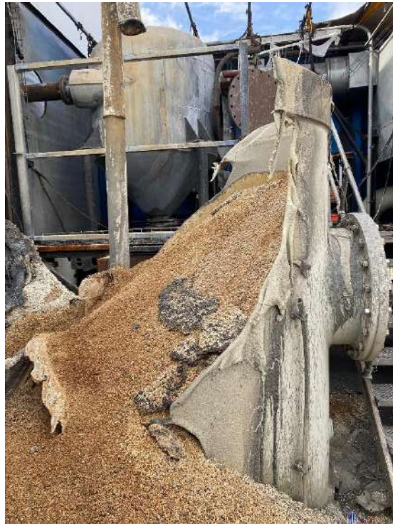
Figure n°4 : cuve détruite par l'incendie
